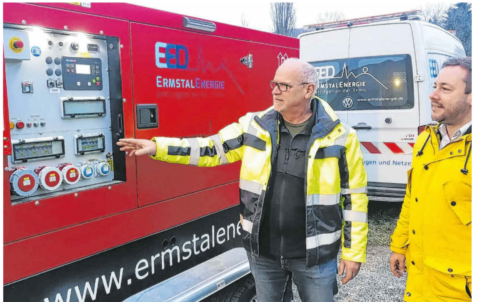
Proben für den energietechnischen Worst Case: Felix Schiffner (rechts), technischer Geschäftsführer der EED, und der technische Leiter Rolf Riesch vor dem Notstromaggregat beim Hauptpumpwerk Schwalbenstadt. Foto: Anja Weiß
